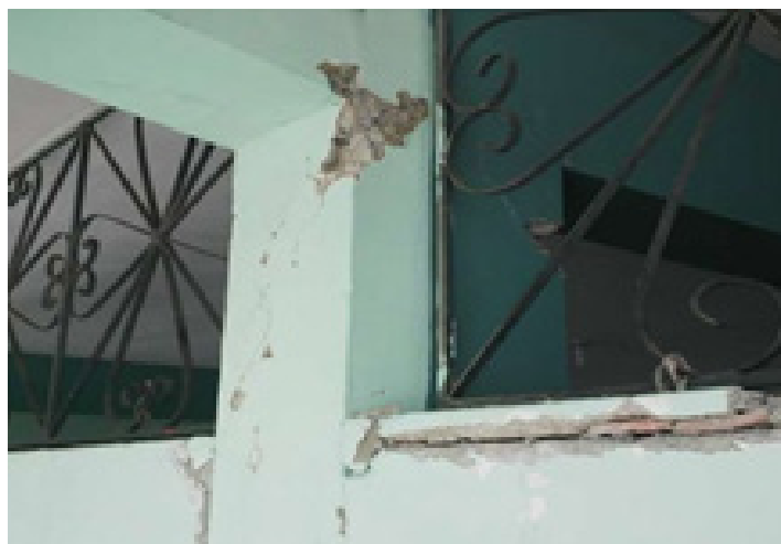
b) Grietas en columna corta
