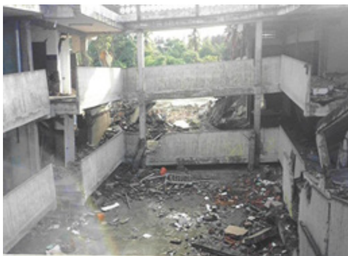
a) Vista interior del Liceo, mostrando el aplastamiento de la Planta Baja.
